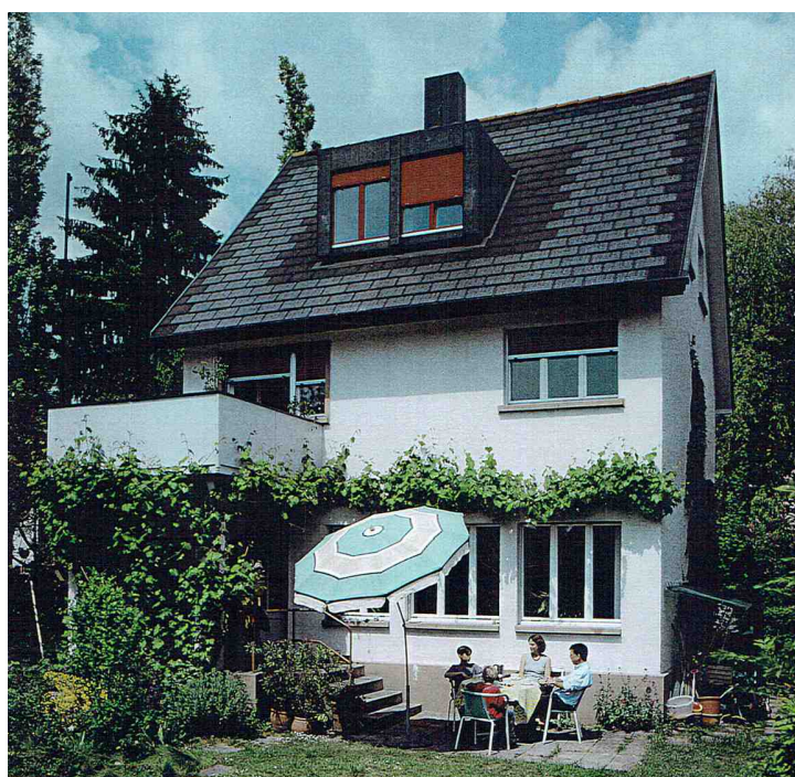
Hausrenovierungsprojekt mit neuem integrierten PV-Dach von Rolf Furrer Architekt. Quelle: Rolf Furrer
