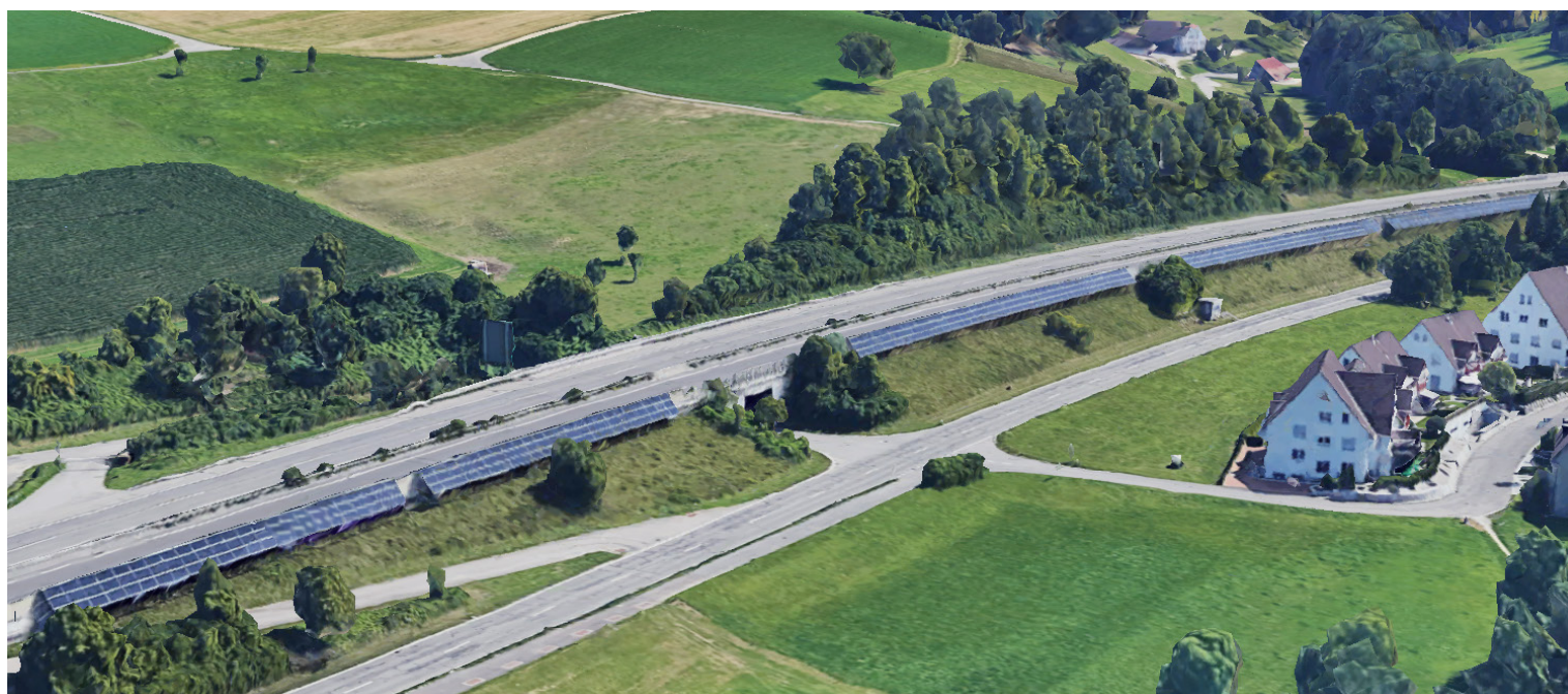
Eine Fotovoltaikanlage an der Aussenfassade einer Lärmschutzwand der Autobahn A2 bei Giebenach, Kanton Basel-Landschaft.
